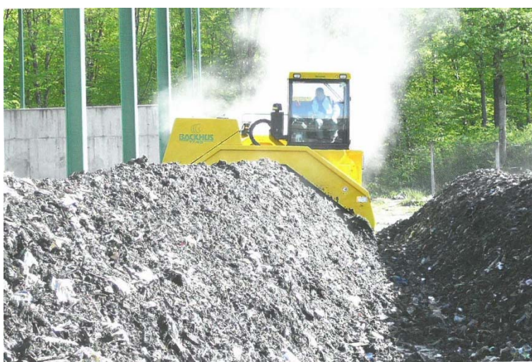
Abbildung 1.1 – Der Betrieb der Maschine zum Wenden von Kompostmieten (Quelle: https://tehnix.hr/en/ )
